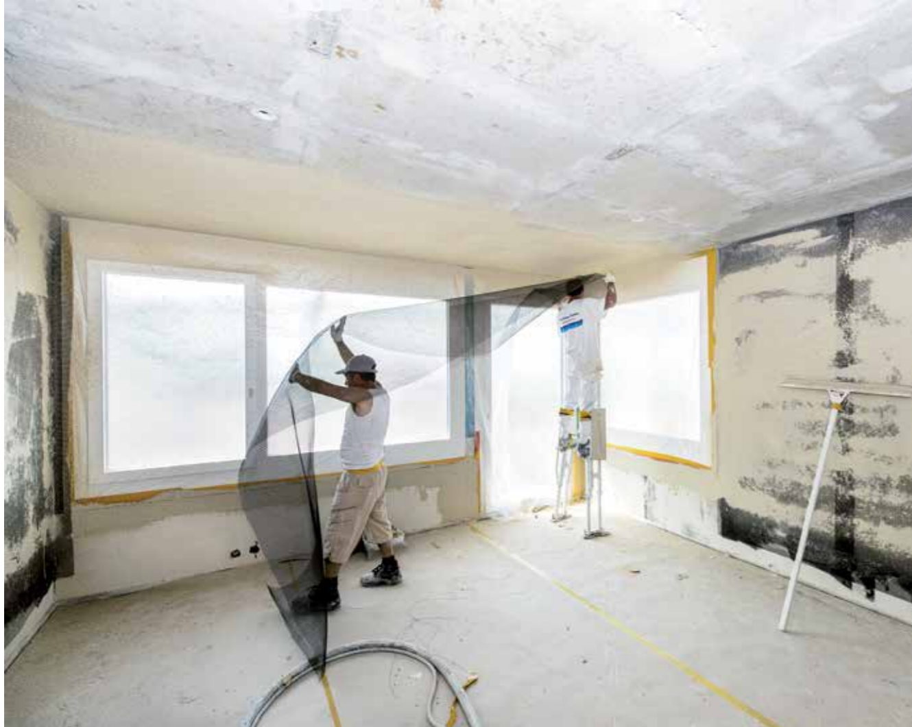
Für den Strahlenschutz bringen die Gipser von Schlagenhauf ein spezielles Abschirmgewebe im ganzen Raum an, das dank Verputz später unsichtbar ist.
